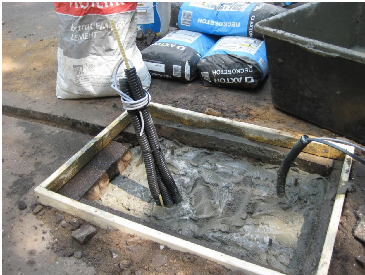
Бетон заливается послойно с обязательным штыкованием для его уплотнения, благодаря чему повышается прочность конструкции.
